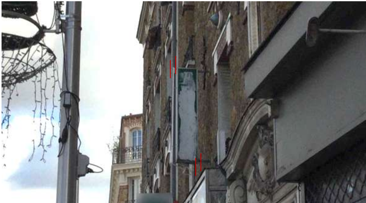
Enseignes perpendiculaires en mauvais état – Saint-Maur-des-Fossés – 2019
